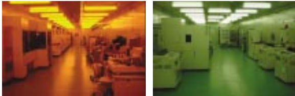
写真1 クリーンルーム
